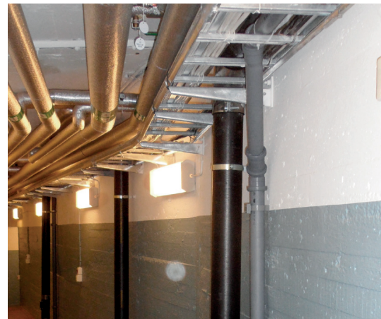
Mehrsträngige Radonabsaugung in einem Schulkomplex.
